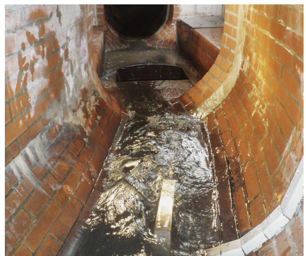
Eine online-Sonde im kanalisiertem Auerbach dient der verschmutzungsabhängigen Steuerung des Abflusses.
